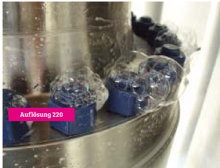
Bild 2: Undichtigkeit: Schaum tritt an der Flanschverbindung aus
